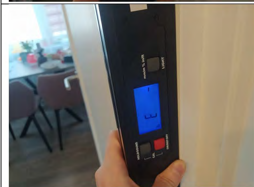
Фото №45. Отклонение коробки дверного блока в кухне.
