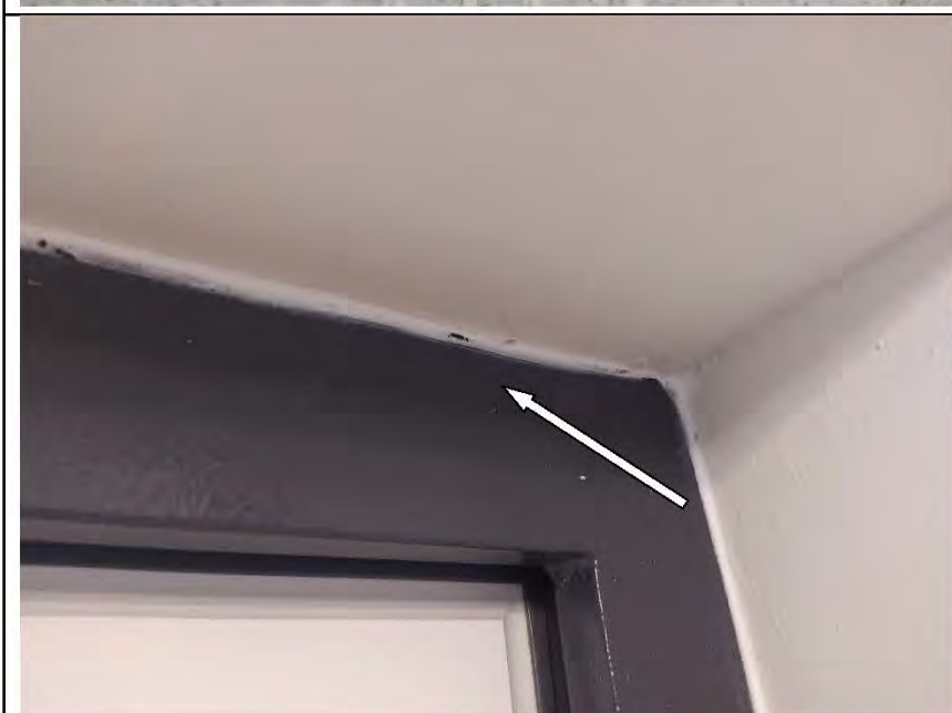
Фото №65. Коробка входной металлической двери имеет дефекты (загрязнение малярными составами).
