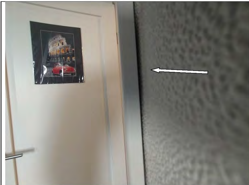
Фото №58. Неплотное прилегание дверного наличника к стене в спальне.
