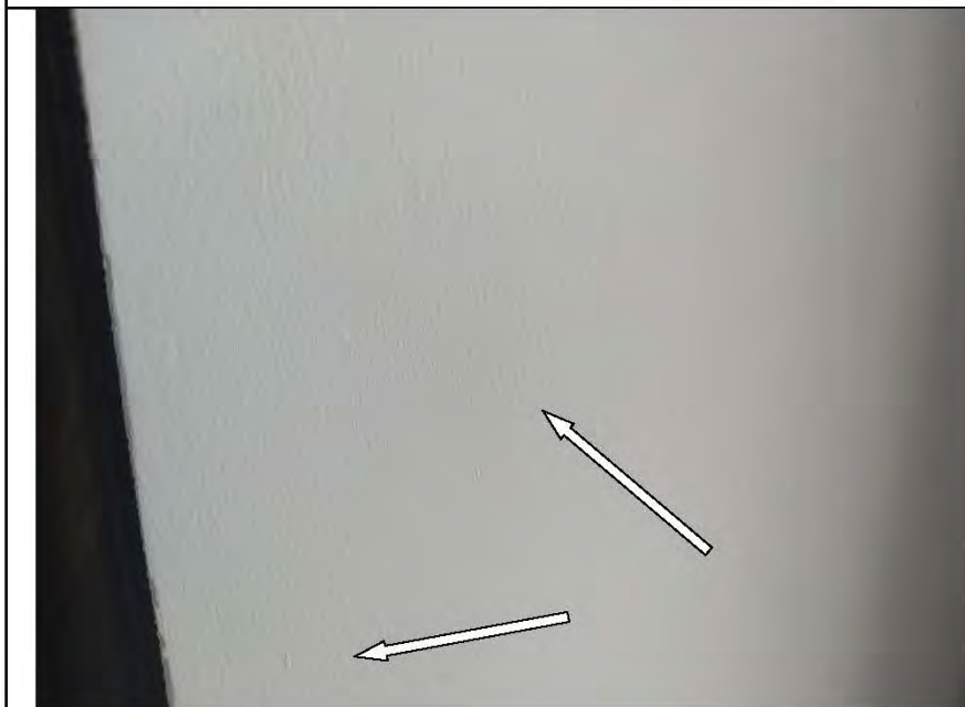
Фото №26. Окрашенные откосы оконного блока ПВХ в спальне выполнены с дефектами (подтеки).
