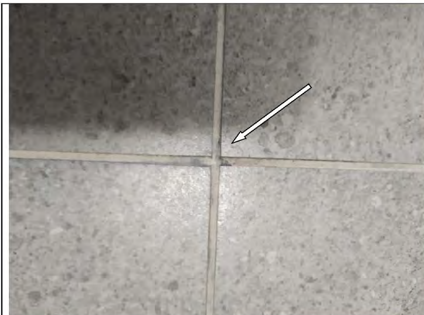
Фото №64. Затирка напольной плитки выполнена с нарушениями в санузле: разность ширины шва.
