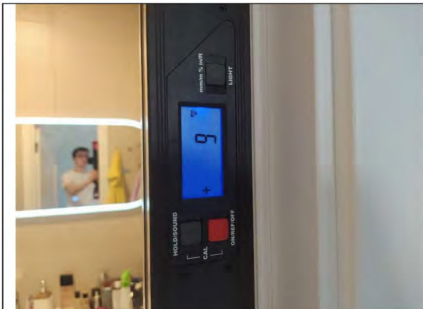
Фото №46. Отклонение коробки дверного блока в ванной комнате.
