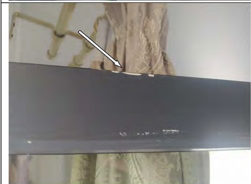
Фото №39. Профиль ПВХ оконно-дверного блока в гостиной имеет дефекты (загрязнение малярными составами).
