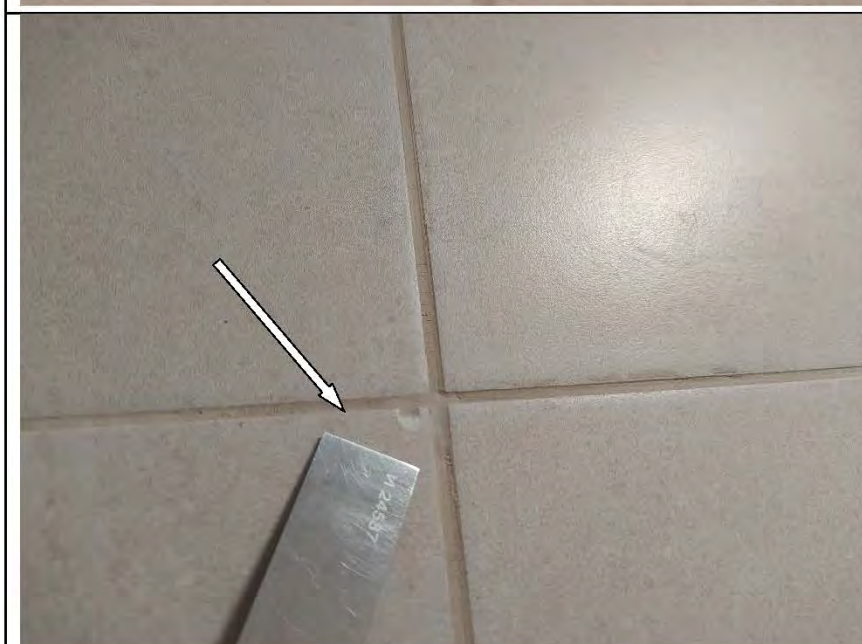
Фото №62. Сколы на настенной керамической плитке в санузле.
