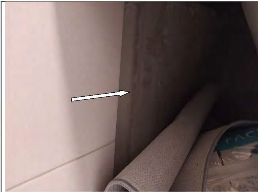
Фото №67. Частично отсутствует настенная керамическая плитка за ванной.
