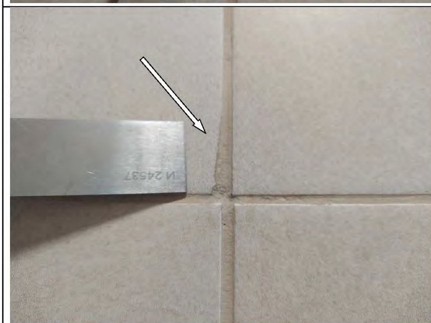
Фото №63. Отбитость на настенной керамической плитке в санузле.
