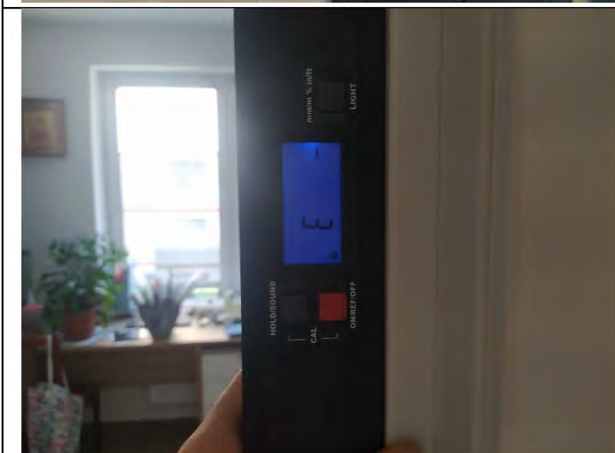
Фото №44. Отклонение коробки дверного блока в детской.
