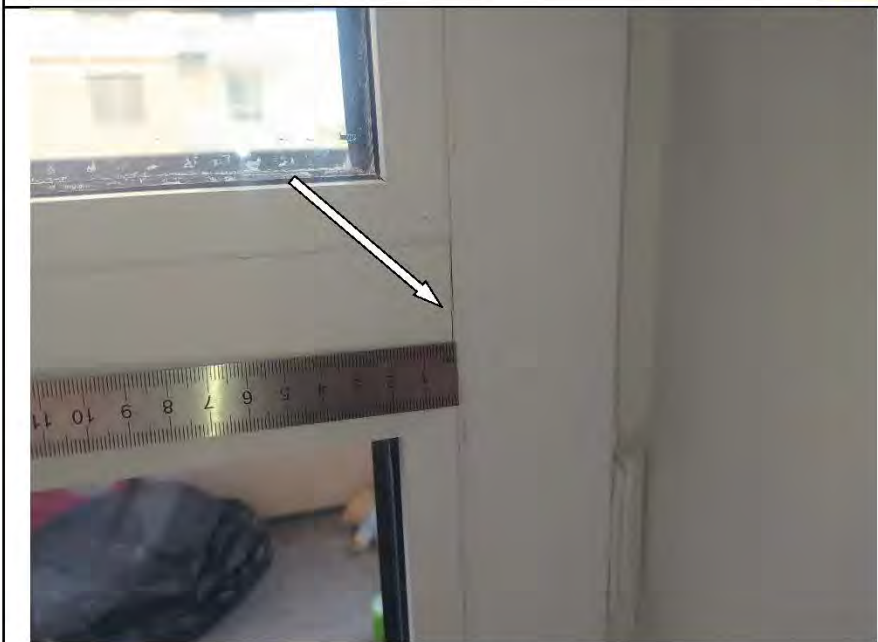
Фото №38. Профиль ПВХ оконно-дверного блока в гостиной имеет дефекты (зазор).
