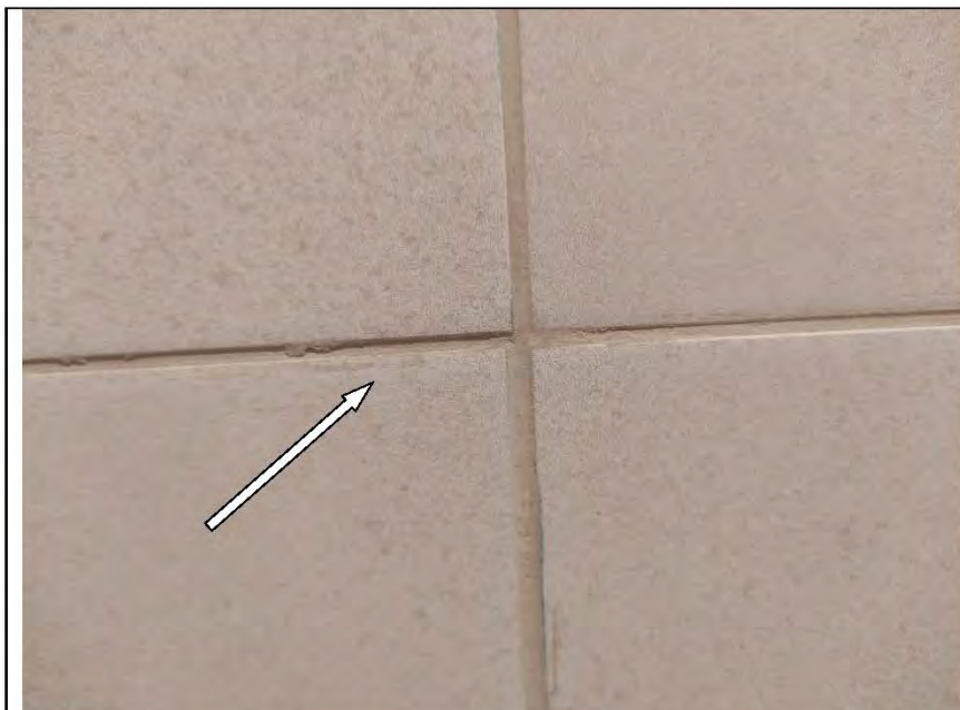
Фото №61. Затирка настенной плитки в ванной комнате выполнена с нарушениями (каверны).
