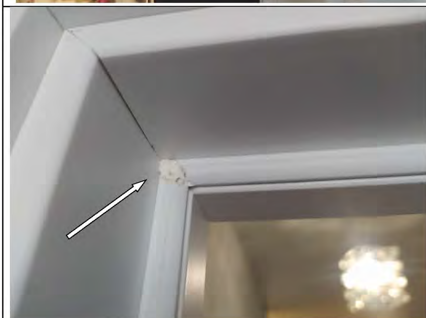
Фото №47. Коробка деревянного дверного блока в гостиной имеет дефекты (загрязнение малярными составами).
