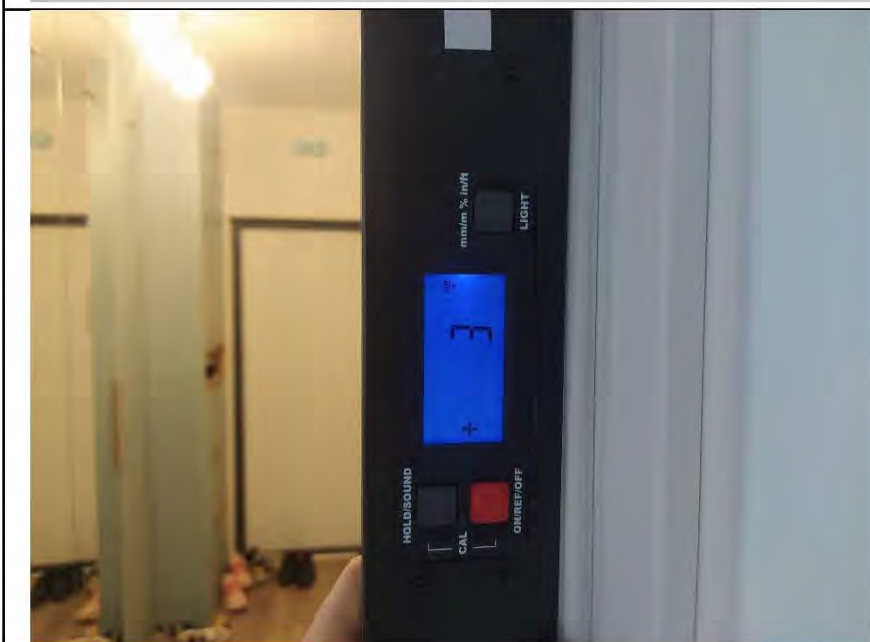
Фото №42. Отклонение коробки дверного блока в спальне.
